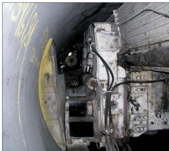
En av spennsylinderne mot sideveggen.
