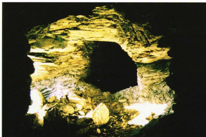
Fig. 2. En av de mange gruvegangene ved Bårstad, hvor deler av taket har begynt å rase ned
