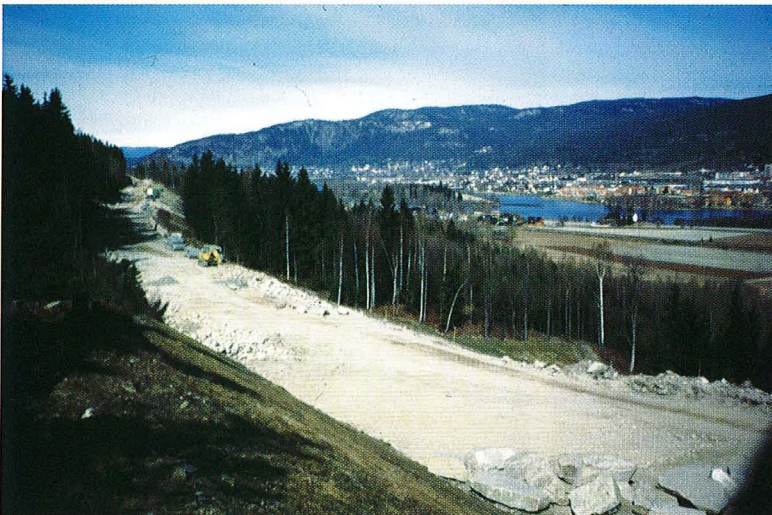
Den nye vegtraseen for E134 ved Gosen, omlag 2 km nord for tunnelen. Retning mot Mjøndalen. Foto Ørnulf Nordli.
