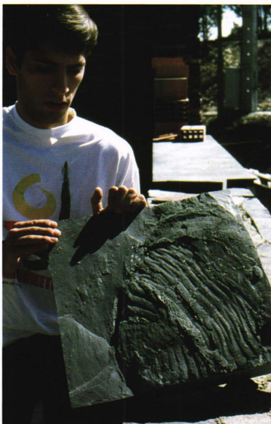
Luis med ubrukelig takstein som var satt til side. Saga har tatt noe av hodet.
